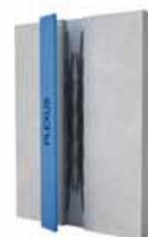
vylomení krytu po odbednění první části konstrukce
